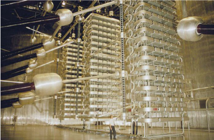
Abb. 8.1 Beispiel von Thyristorventilen einer 500-kV-HGÜ-Anlage – Anordnung in einer Ventilhalle; links im Bild die Durchführungen der Drehstromanschlüsse. (Quelle: ABB)
