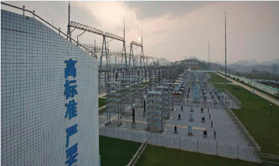
Abb. 8.11 Blick auf den AC-Anlagenteil einer LCC-HGÜ-Kopfstation in China (Gui-Guang II, Gleichspannung: \pm 500 kV/Nennleistung: 3.000 MW) [SIEMENS]
