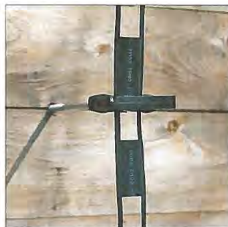
Bild 3: Leitungsführung an einer Holzwand
