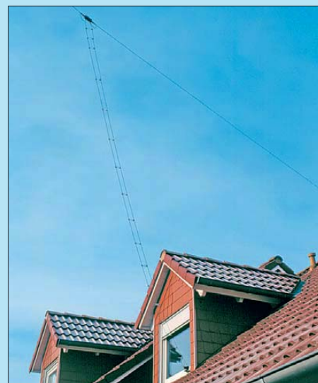
Bild 12: Dipolantenne mit einer „Hühnerleiter“ als Speiseleitung
