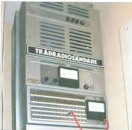
Drahtfunktender für LW-Kanäle zur Einspeisung ins Telefonnetz
