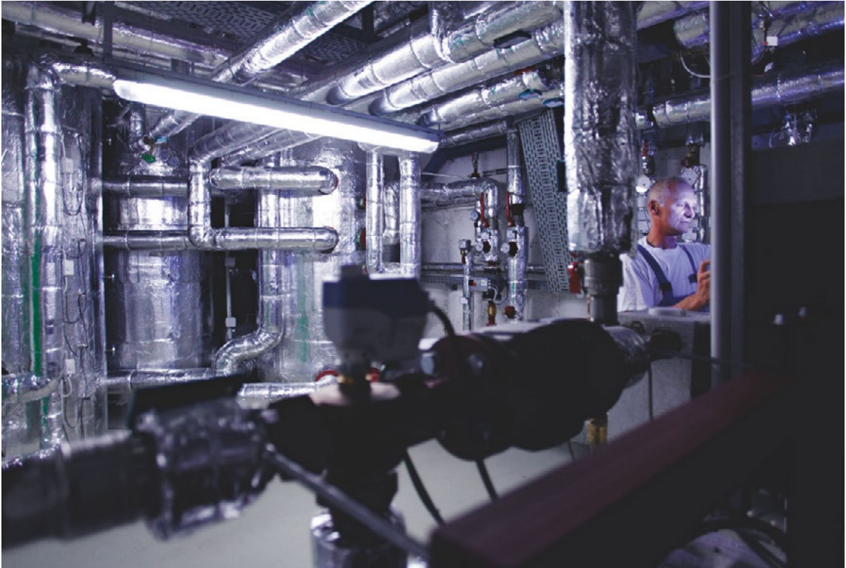
Nur keine Energie verschwenden: Haustechniker Christian Laus prüft die Wärmepumpe, alle Rohre sind perfekt isoliert.
