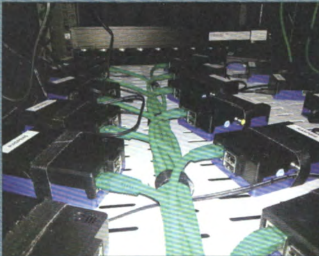
1 Eine Raspberry-Pi-Kolonie im Server-Rack.
