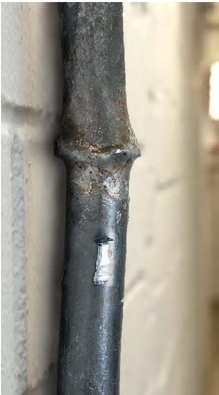
Wulstige Lötverbindungen sind ein Merkmal von Rohren aus Blei. An angekratzten Stellen glänzen sie silbrig.
