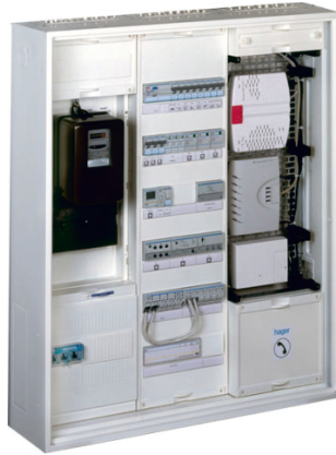
Bild 16.12: Zählerplätze in Gebäuden [46]
