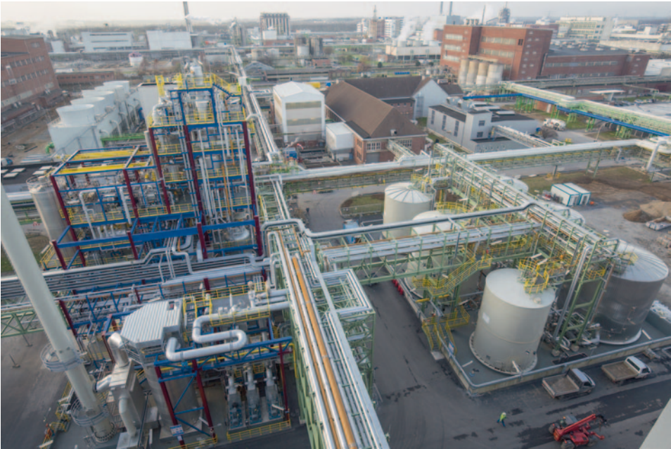
Abb. 7.5 Rohrbrücken innerhalb der TDI Anlage von Bayer Dormagen. (Bild: Bayer AG)
