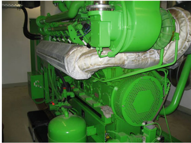
Abb. 8.11 Gasmotor und Generator
