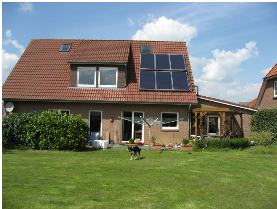
Abb. 3.8 Außenansicht der Beispielanlage nach Abschn. 3.3, Kollektoranordnung
