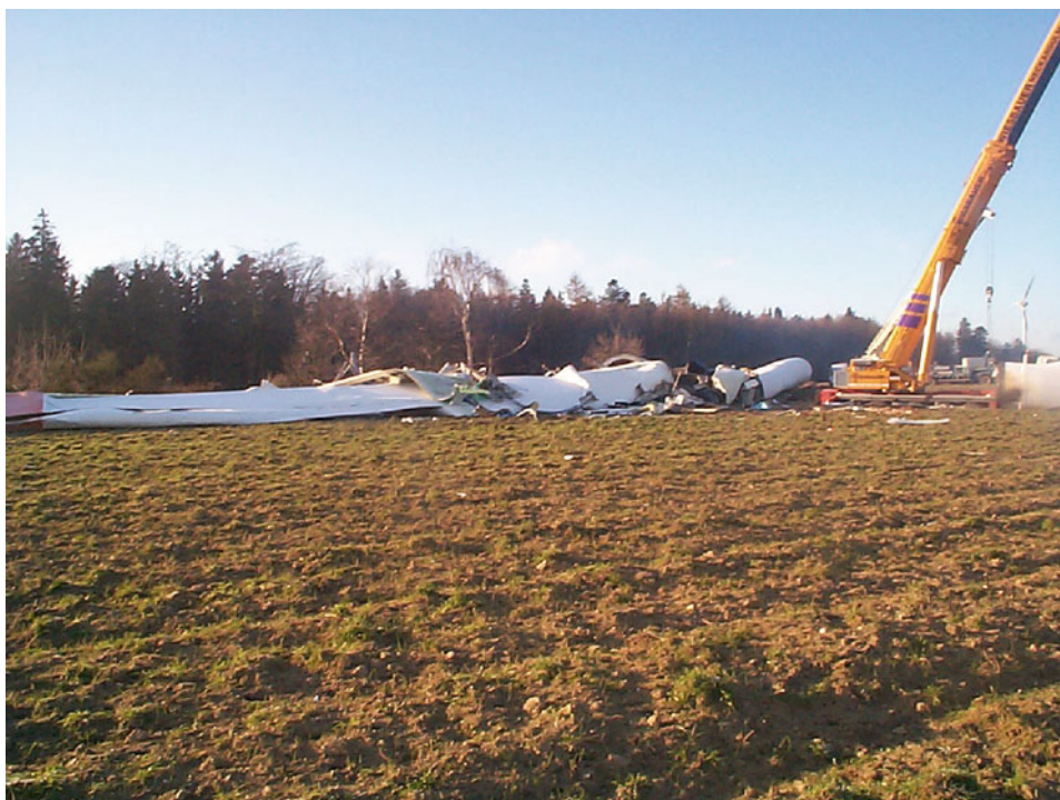
Abb. 4.24 Havarierte Windkraftanlage (Foto: Praktikant, HAW Hamburg)
