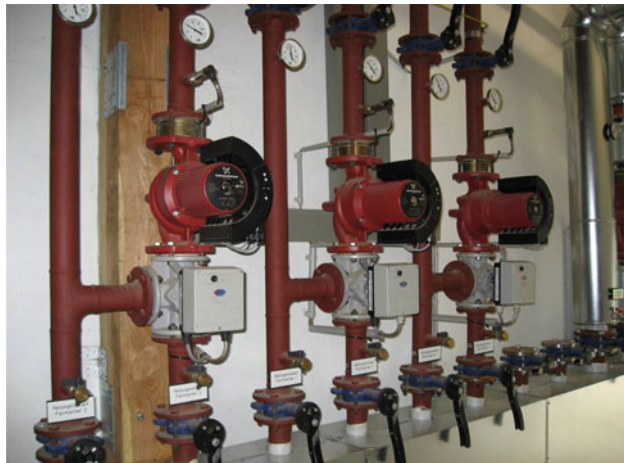
Abb. 8.12 Umwälzpumpen zur Beheizung des Fermenters mit Abwärme
